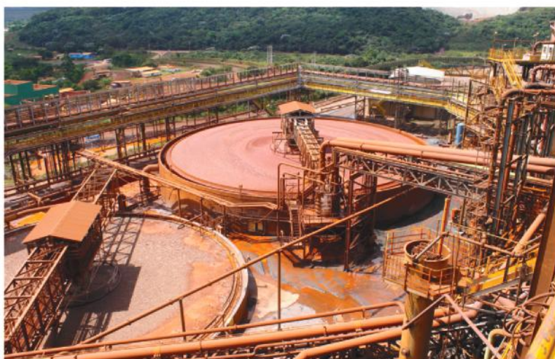
Fornecimento: SAMARCO MINERAÇÃO 1,5 a 10MVA - 15/7,2kV - IP-31
