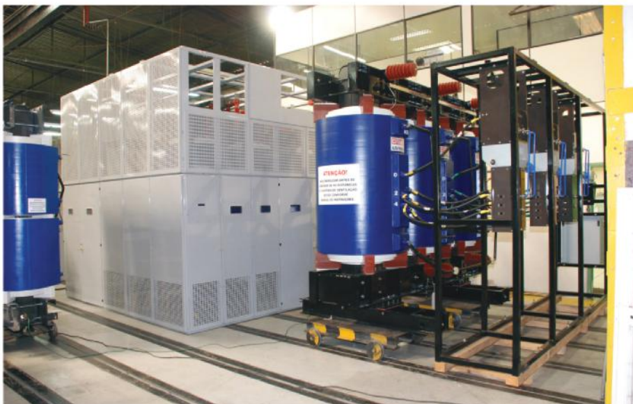
Fornecimento: PETROBRÁS 7500 KVA – 36,2/15KV com comutação sob carga
