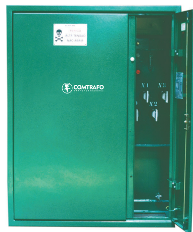
Vista frontal (abertura da AT após abertura da BT)
